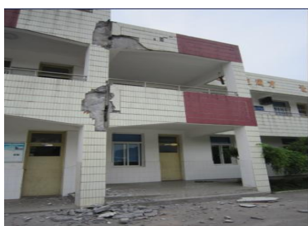
图 19 4.20 芦山地震损失-1
