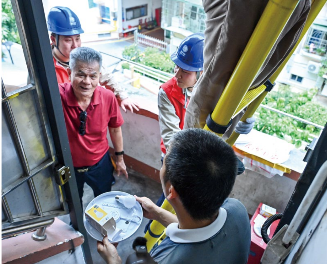
三楼转弯处的吸顶灯已脱落悬在墙上，庄爷爷对志愿者说，自己孩子出差了，灯太高修不了，建议把灯放低些。摄影/林丽雅
